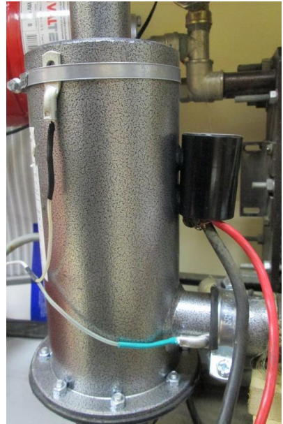
Рисунок 1.2 – Установка датчиков температуры обратки и подачи на корпусе электрокотла.
